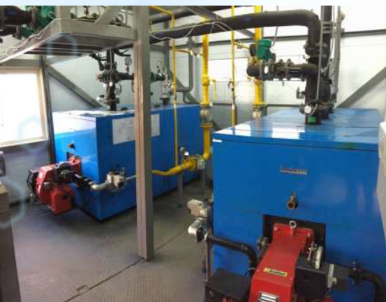
Водогрейная котельная Литицинский городской округ, д. Юдино, Пяловские дачи.
