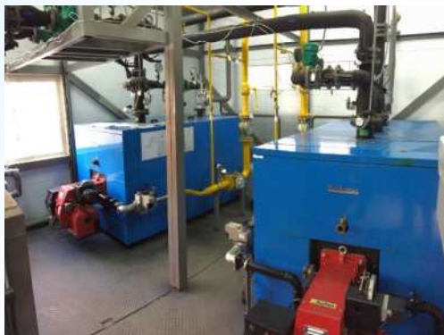
котельные малой мощности до 2-3 МВт
