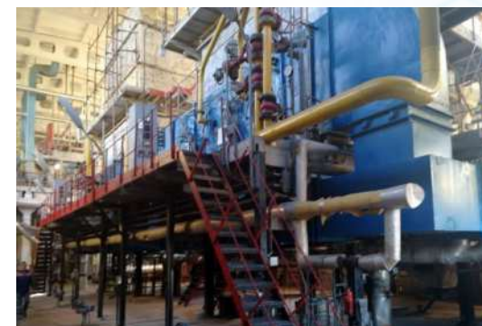
котел ПТВМ 30 до 35 МВт
